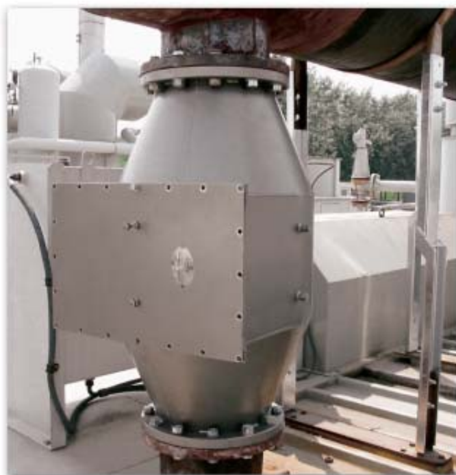
DEPURATORE CATALITICO installato presso impianto biogas di Guidonia (RM)
